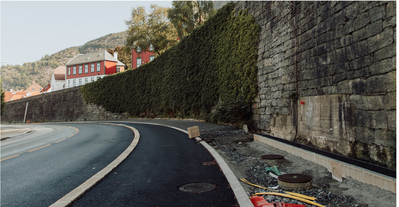
Bygging av sykkelstamveg nordover frå sentrum har starta, med delstrekinga Bradbenken–Glass Knag. Foto: Karoline Rage/Statens vegvesen.
